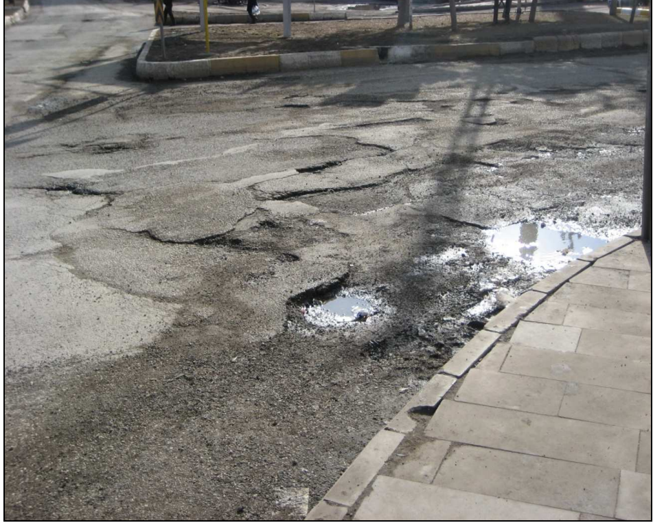
Şekil 1. 1. Drenaj yetersizliğinden yolda çukurluklar ve kısmi oturmalar
