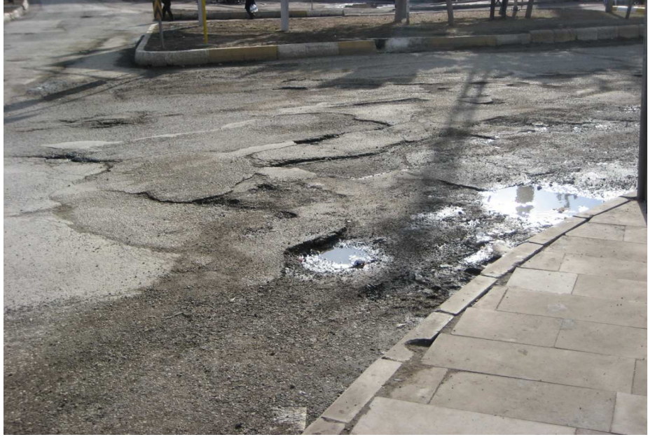
Şekil 4.2. Suyun yoldan uzaklaştırılamaması sonucunda oluşan bozukluklar
