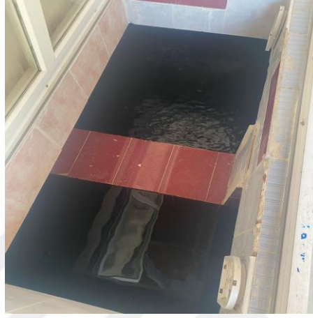
Şekil 13. Suyun Tesise Girmeden Önce Dinlendirildiği Ham Su ve Arıtılmış Su Depoları
