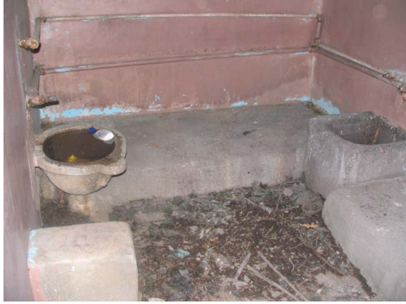
Resim 4.112: Hamamın Onarımdan Önceki Halvet Hücresi
