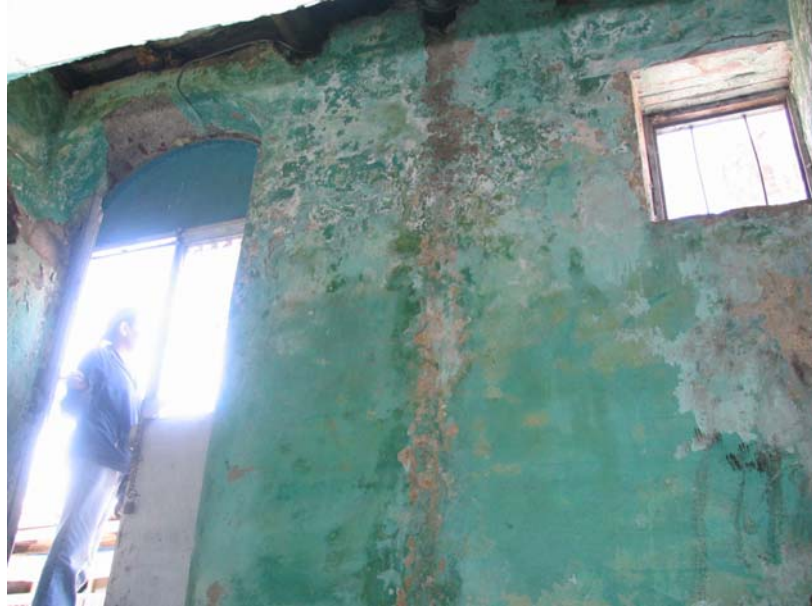
Resim 4.109: Hamamın Onarımdan Önceki Giriş Kısmı
