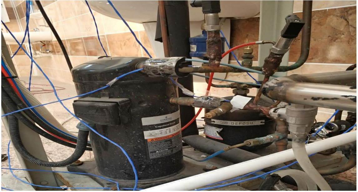
Şekil 38. Sistemde kullanılan kompresör fotoğrafı.
