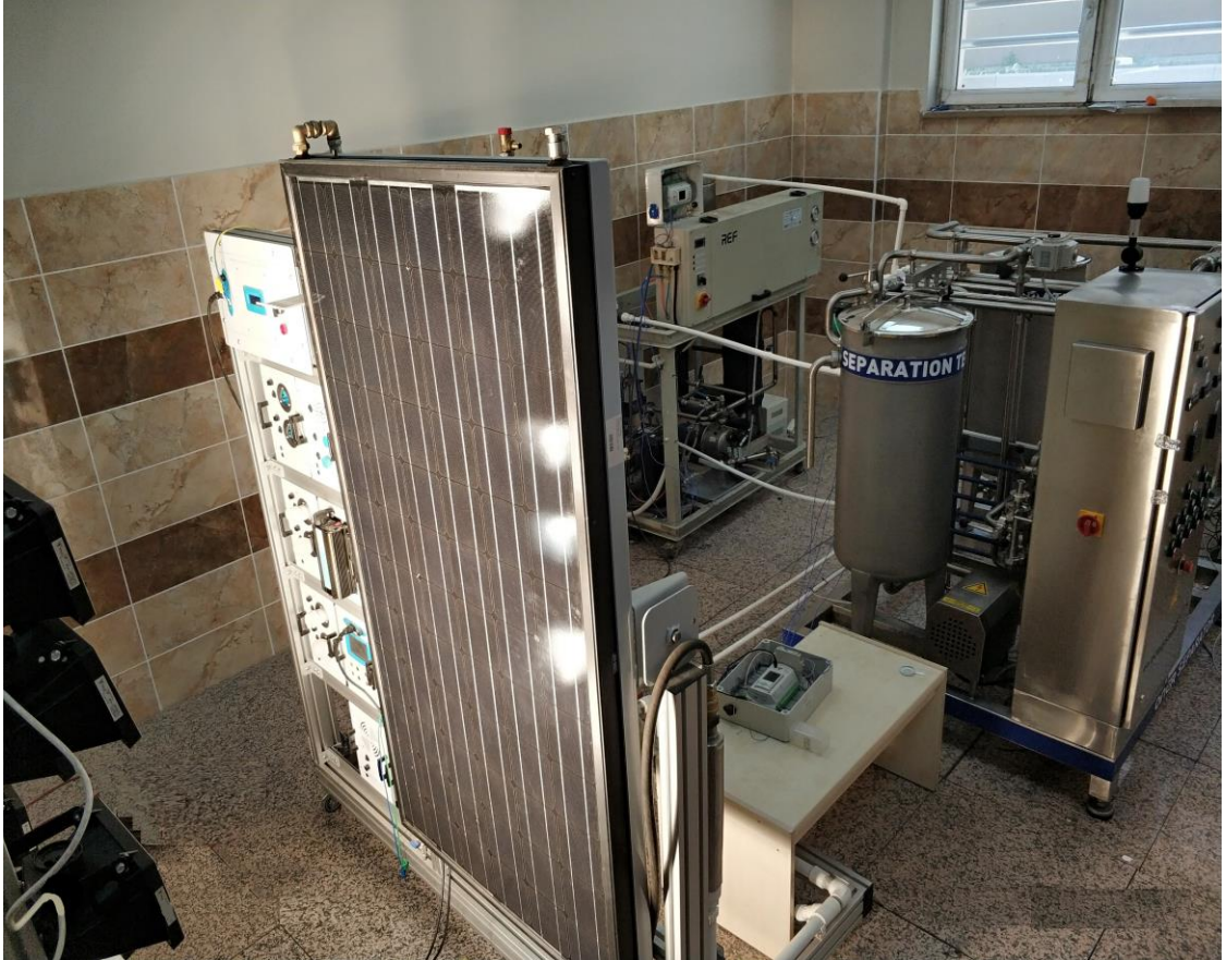
Şekil 35. PV/T destekli ısı pompası sistemi genel görünüm fotoğrafı.
