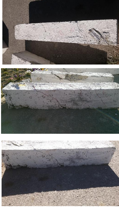
Şekil 4.29. NC4E10-3 numunesinde meydana gelen burulma çatlakları
