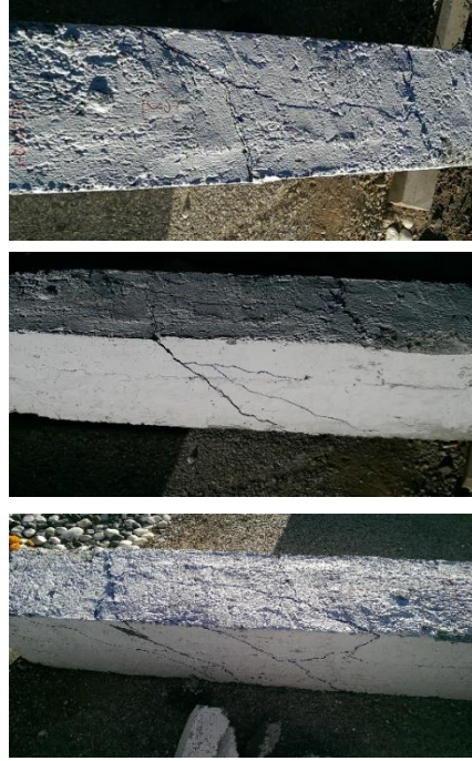
Şekil 4.27. NC4E10-1 numunesinde meydana gelen burulma çatlakları
