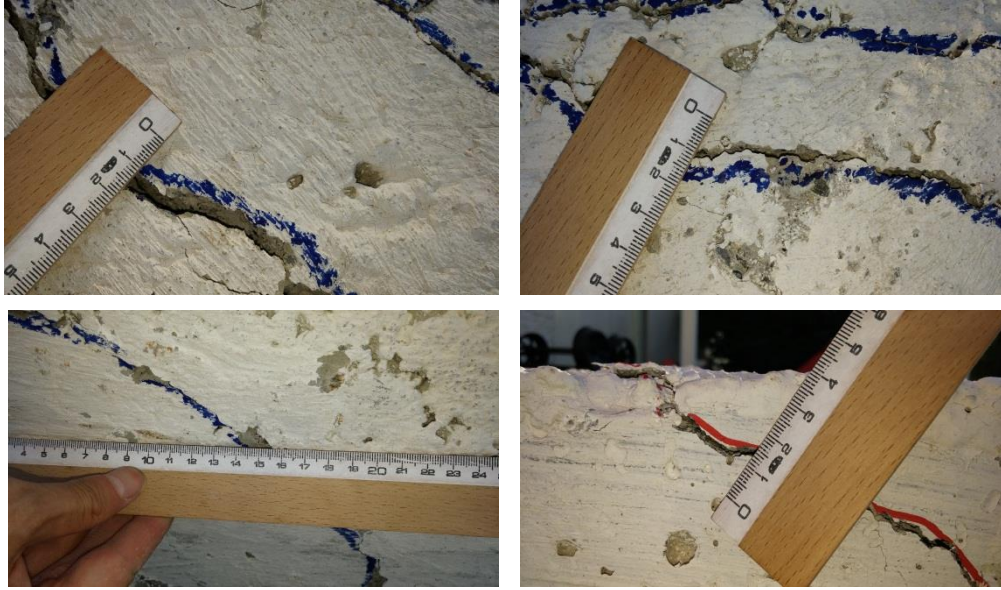
Şekil 4.55. Normal beton numunelerinde meydana gelen çatlak genişlikleri
