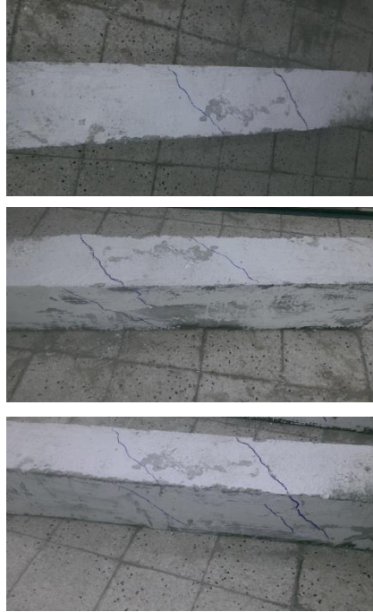
Şekil 4.48. KC2E8-2 numunesinde meydana gelen çatlaklar
