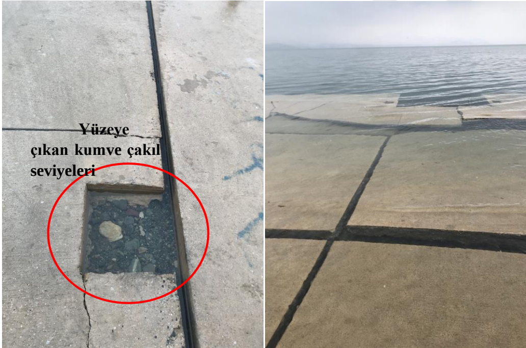
Şekil 49. 24 Ocak 2020 Elazığ depremi sonrası Sivrice iskelesi beton plakları (Gökçeoğlu vd 2020)
