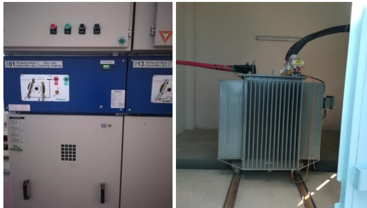
Şekil 3.9. Erzurum Kombina Tesisinin elektrik ihtiyaçlarını karşılamak için kullanılan ekipmanlar
