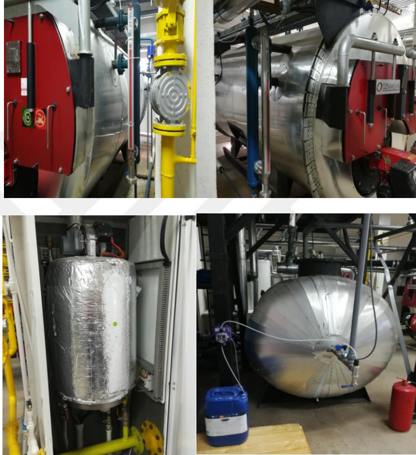
Şekil 3.6. Erzurum Kombina Tesisinde ısıtma için kullanılan ekipmanlar
