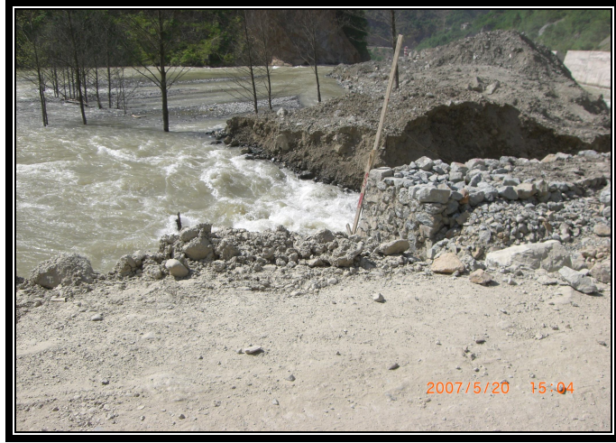
Şekil 4.38. Köknar-Çaykara arası yol güzergahında sel tahribatı
