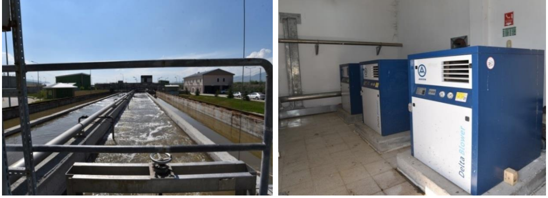
Şekil 3.10. Havalandırılmalı kum ve yağ tutucu ünite ve blowerler
