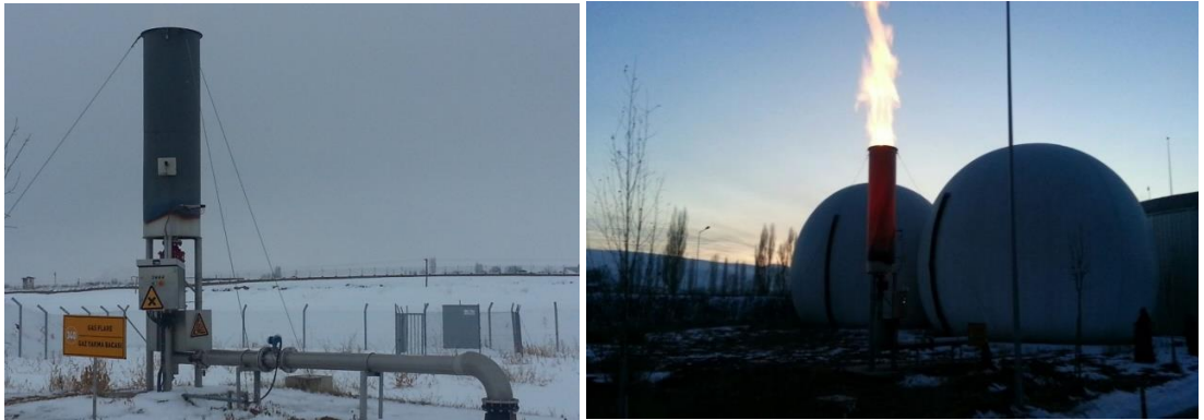
Şekil 3.31. Atık gaz yakma bacası
