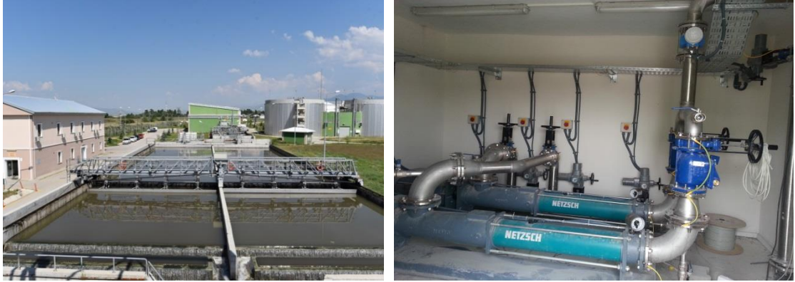
Şekil 3.13. Ön çökeltme havuzu ve birincil çamur pompaları
