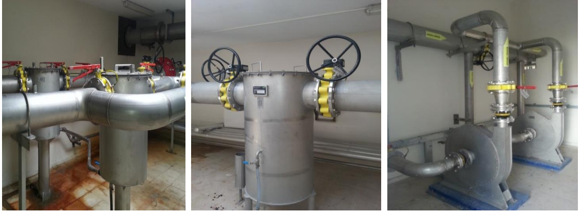
Şekil 3.29. Çakıl filtreler, yoğuşma tankı ve gaz booster pompaları
