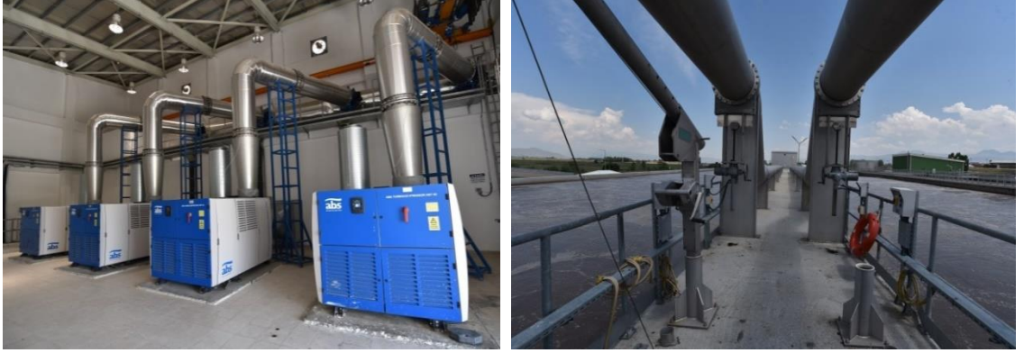
Şekil 3.19. Havalandırma blowerleri ve basınçlı havalandırma hatları
