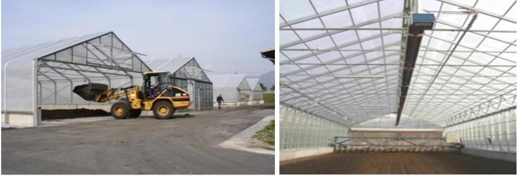
Şekil 4.16. Solar enerjiyle çamur kurutma seraları
