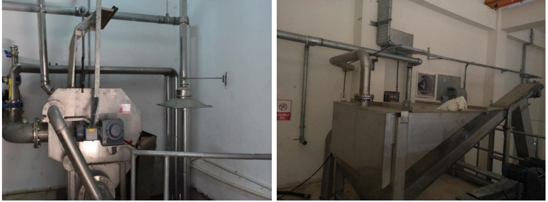
Şekil 3.11. Tambur elek (yüzen çamur, yağ-köpük) ve kum ayırıcı ekipmanı
