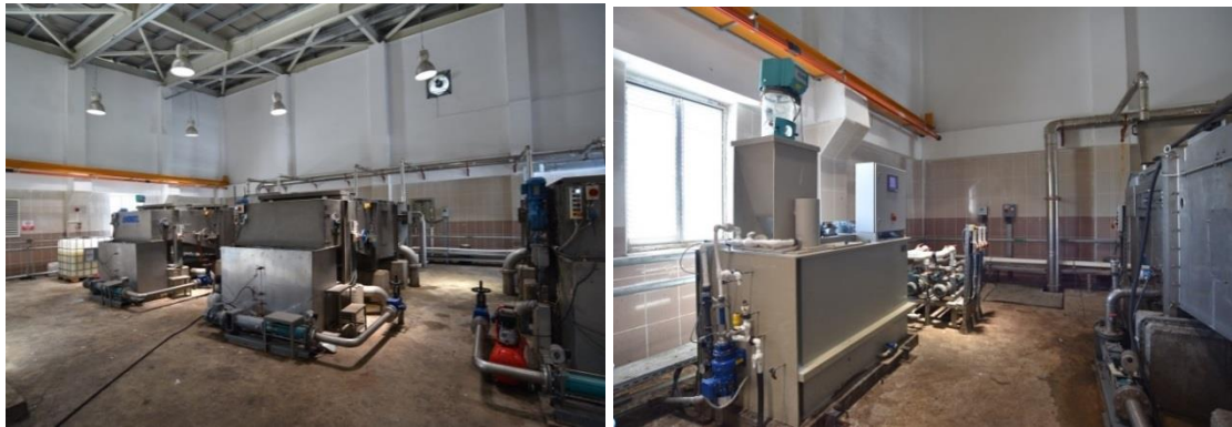
Şekil 3.22. Mekanik çamur yoğunlaştırıcı (belt filtre pres) ve polimer hazırlama ünitesi
