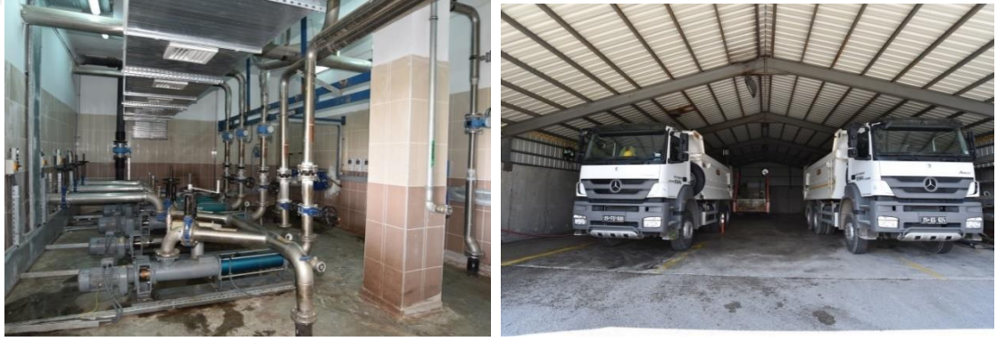
Şekil 3.35. Çamur besleme pompaları ve sızdırmaz tip çamur taşıma kamyonları
