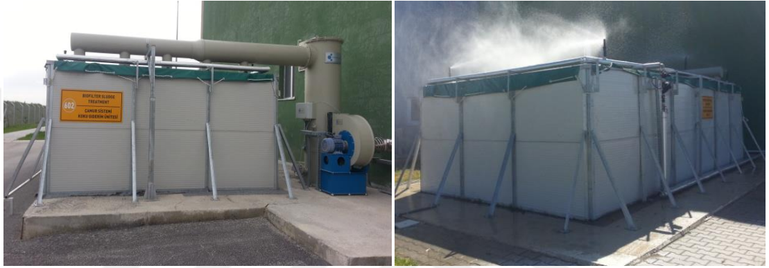
Şekil 3.36. Izgara ve çamur binaları koku arıtma üniteleri (biyofiltre)
