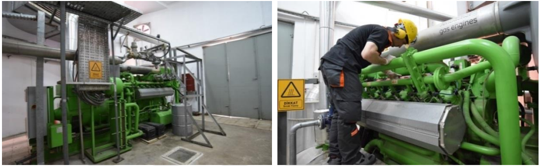
Şekil 3.25. Biyogaz yakma motorları (kojenerasyon)
