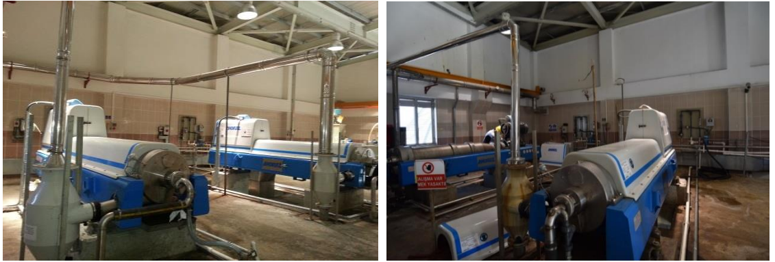
Şekil 3.33. Çamur susuzlaştırma ekipmanları (santrifüj dekantör)
