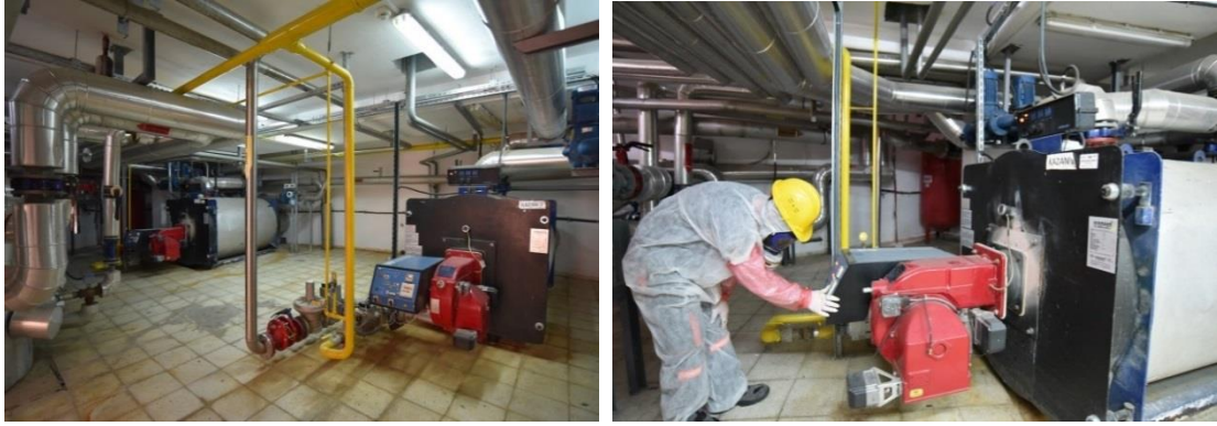
Şekil 3.26. Biyogaz ve doğalgaz yakma ısı kazanları (boiler)
