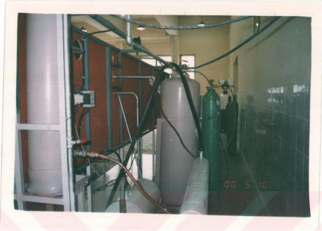
Şekil 5.5. Ana besleme tankının görünüşü
