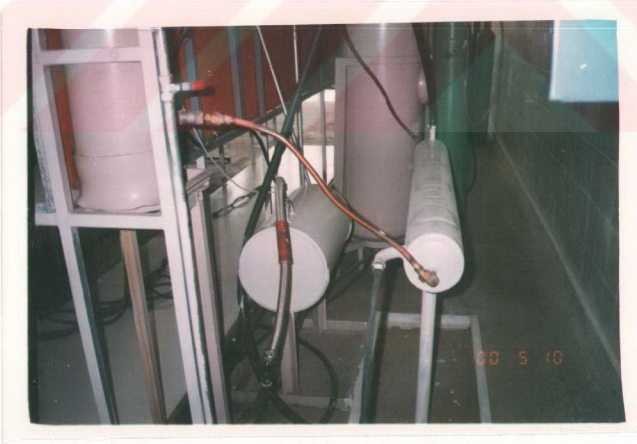
Şekil 5.9. Isı eşanjörü ile dengeleyici tankın görünüşü
