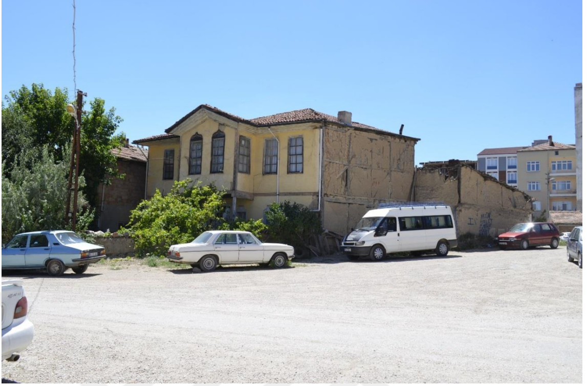
Fotoğraf 4.4. Harmanlar Mahallesi’nde Yıkılma Tehlikesi İle Karşı Karşıya Olan Geleneksel Bir Ev.
