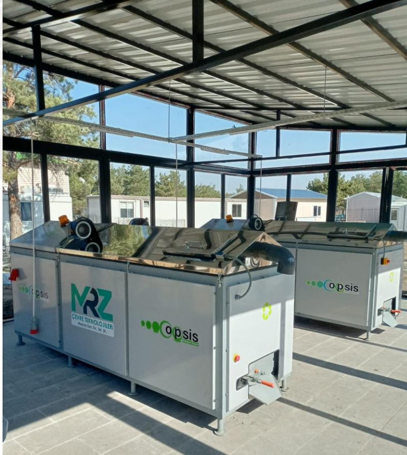
Şekil 2.1 Kompostlama tesisi içerisinde bir görünüm
