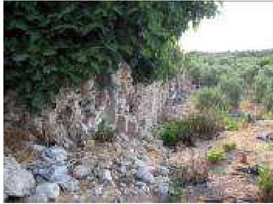
Resim 79: Bouleterion Surları Dökülen Taşlar
