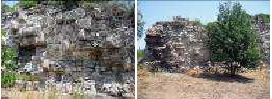
Resim 138-139: Doğu Surlarında Fons Cupidinus Çeşmesi Surları Dökülen Blok Taşlar
