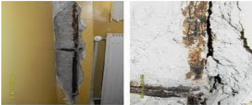
Şekil 1.4. Bir bodrum kat kolonunda oluşmuş çatlak korozyonu resmi (Anonim 2011)
