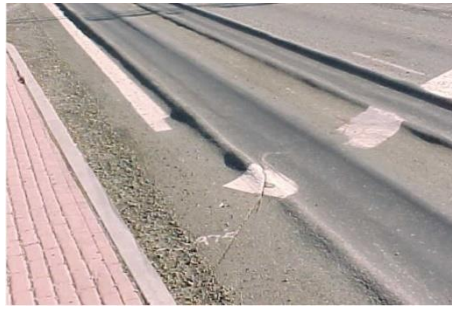
Şekil 16. Tekerlek izinde oturma hasarı (Hanlı,2009)
