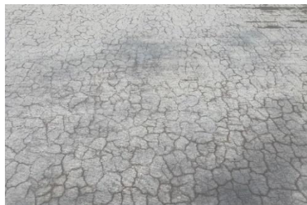
Şekil 30. Rijit üstyapı kaplamasında görülen donma çözünme çatlağı örneği
