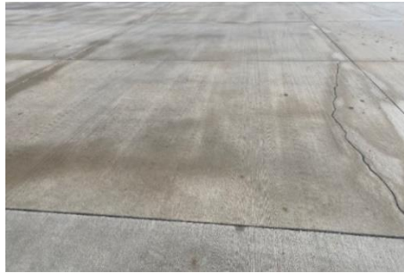
Şekil 28. Rijit üstyapı kaplamasında görülen uzunlamasına çatlak örneği
