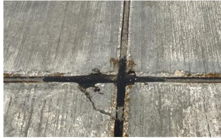
Şekil 29. Rijit üstyapı kaplamasında görülen köşe çatlağı örneği
