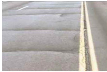
Şekil 18. Termal çatlak hasarı (Hanlı,2009)
