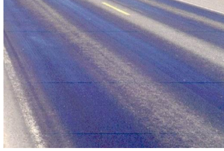
Şekil 26. Asfalt kusması hasarı (Insapedia, 2018)
