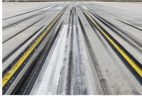
Şekil 33. Rijit üstyapıda gözlenen kirlenme örneği
