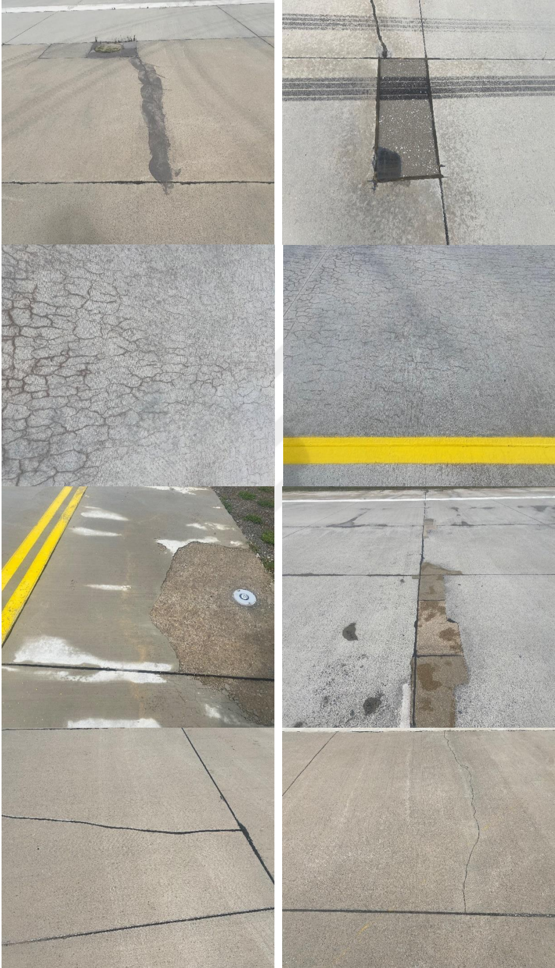
Şekil 50. Hasarlı yüzeye ait veri seti örnekleri
