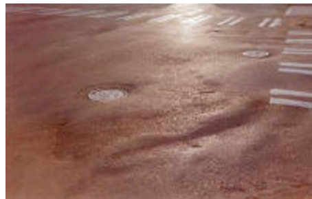
Şekil 23. Asfalt kayması hasarı (Erdoğan, 2019)
