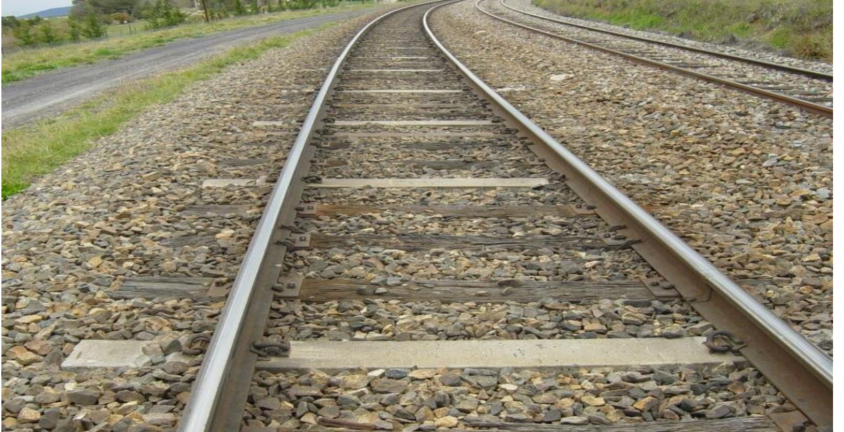
Şekil 10. Ön gerilimli geopolimer beton demiryolu traversleri. (Goulburn, NSW,Avustralya)
