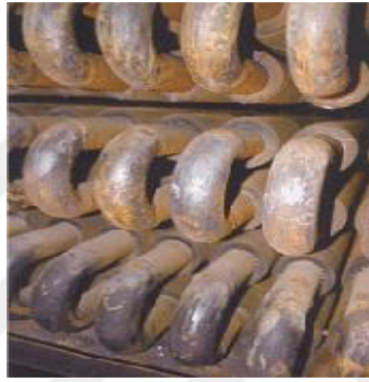
Şekil 21. Isı değıştiricisinde yüksek sıcaklık korozyonu (Anonim 2007).
