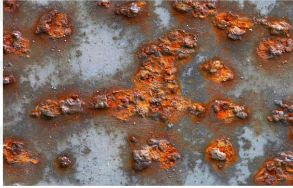
Şekil 19. Taneler arası korozyon hasarı (Alamri 2020).
