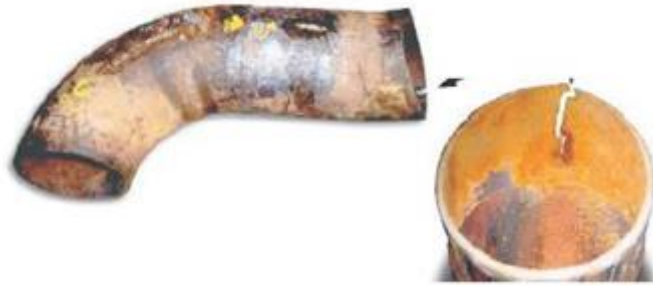
Şekil 22. Boru ek yerlerinde erozyon korozyonu (Anonim 2007).
