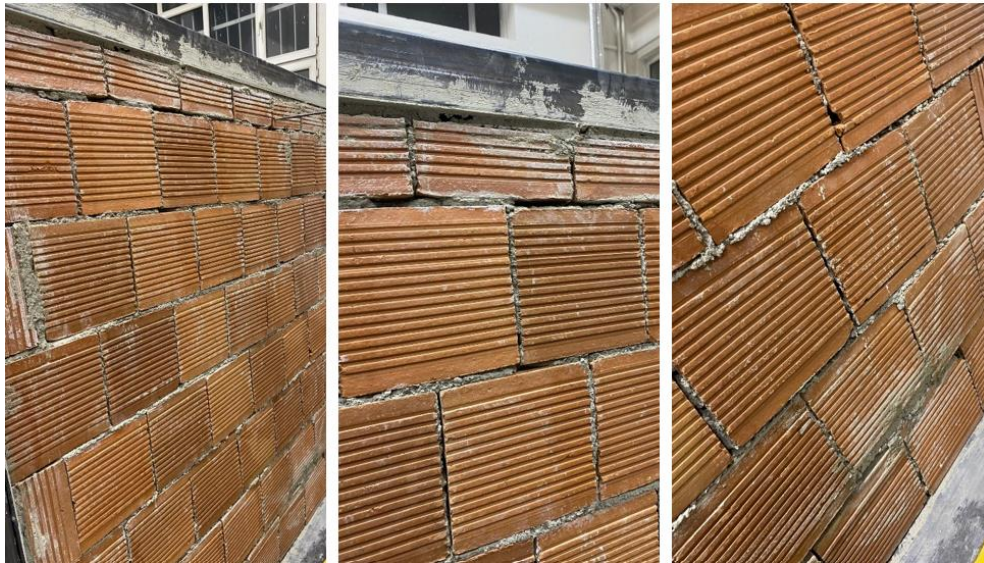
Şekil 84. Düzlem içi durumda EDGBH modelinde oluşan hasarlar
