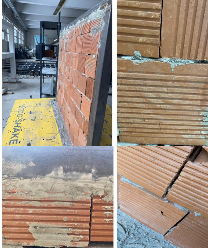
Şekil 81. Düzlem içi durumda RBGH modelinde oluşan hasarlar
