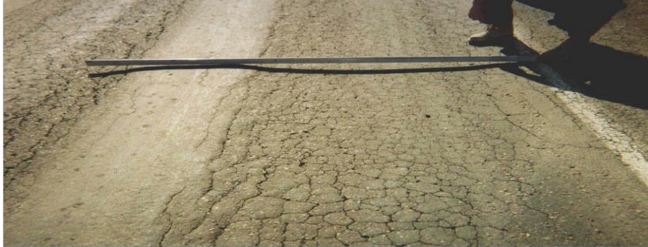
Şekil 5. Orta Siddette Timsah Sırtı Çatlak (Asfalt 2002)
