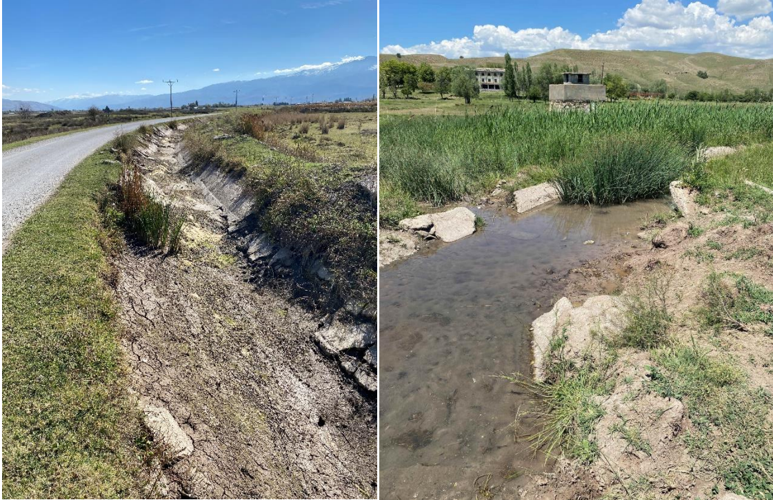
Şekil 14. Mevcut sulama şebekesinden tahrip olmuş kanallar (Özgün, Şeyma ÖZGENEL)
