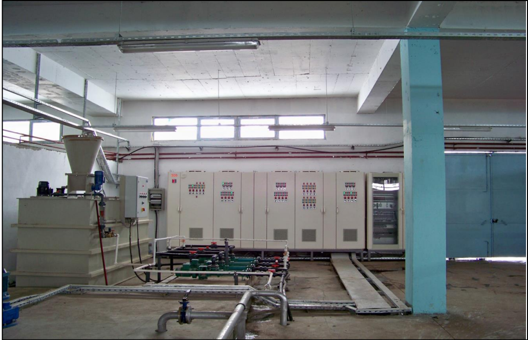
Şekil 10. İçme suyu arıtma tesisine ait örnek kimyasal dozlama ünitesi
