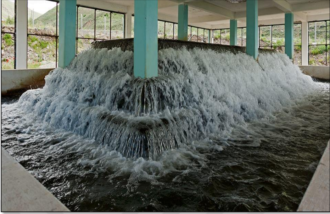
Şekil 8. İçme suyu arıtma tesisine ait örnek havalandırma ünitesi
