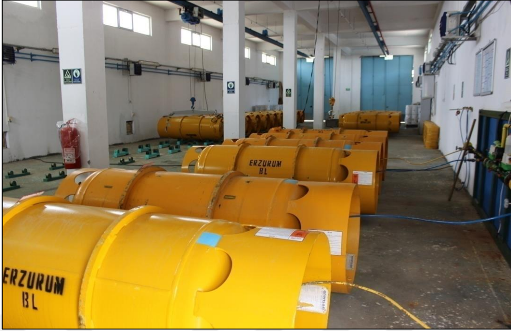
Şekil 13. İçme suyu arıtma tesisine ait örnek klorlama ünitesi
