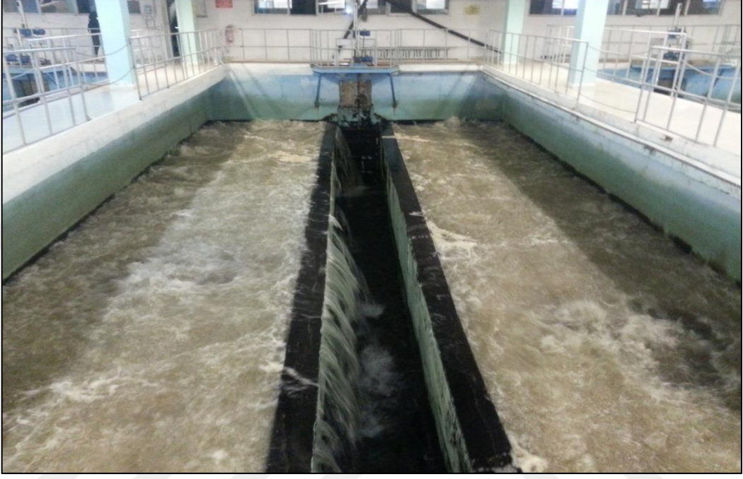
Şekil 12. İme suyu arıtma tesisine ait rnek filtrasyon nitesi
