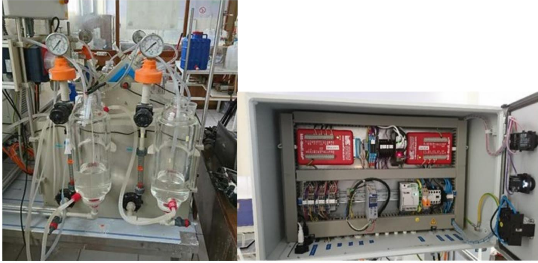
Şekil 3.8. Pompalama seti ve kontrol paneli
