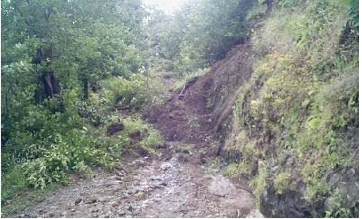
Fotoğraf 1.1 Toprak Akması Sonucu Kapanan Boztepe Mahallesi Yolu.
