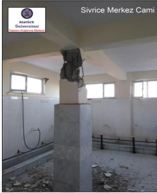
Şekil 15. Elazığ Sivrice Merkez Camii içindeki kolonda meydana gelen hasar (ATADAM, 2020)
