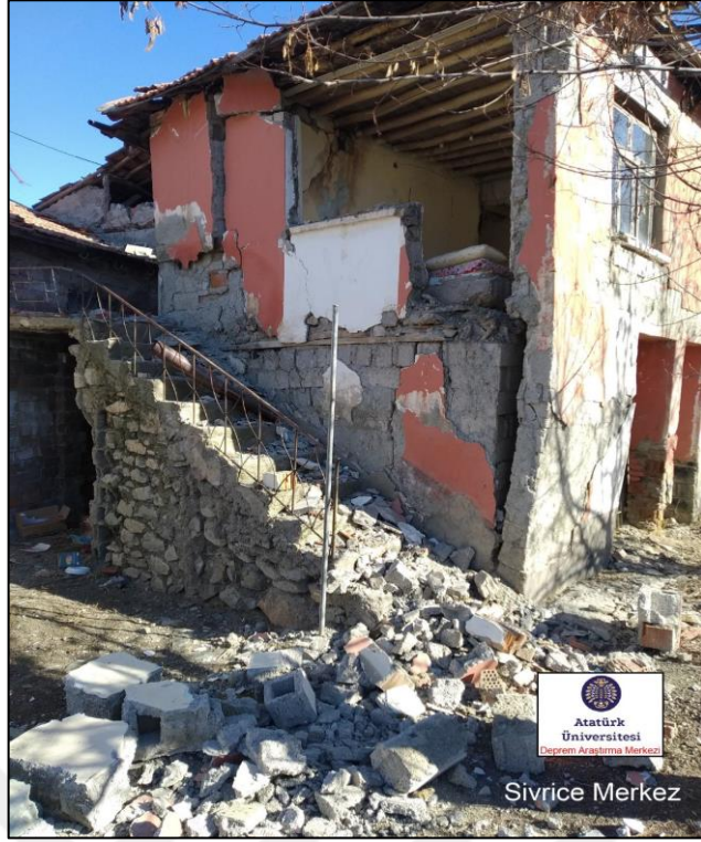
Şekil 13. Elazığ Sivrice’den hasar gören yapılara ait görseller (ATADAM, 2020)
