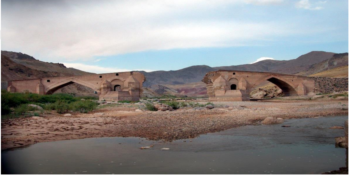
Fotoğraf 3.41. Kız Köprüsü'nün 1946 yılında yıkılan orta gözü hala tamir edilmemiştir.
