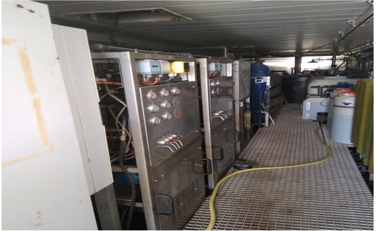
Şekil 25. Sızıntı suyu arıtma tesisi dış ve iç görüntüleri
