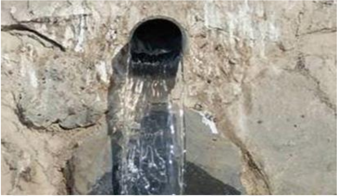
Şekil 37. Tesisi çıkış suyu görüntüsü Sızıntı suyu arıtma
