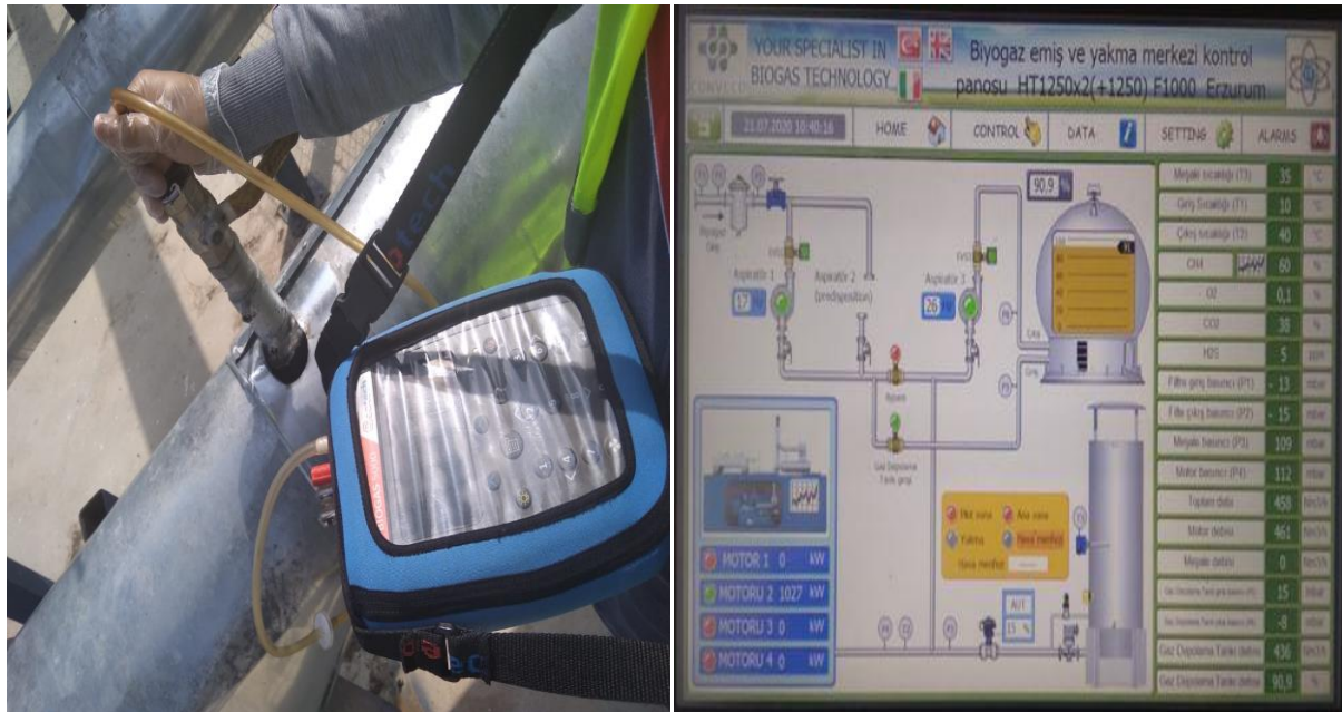
Şekil 29. Günlük depo gazı okuma ve PLC Scada sistemi
