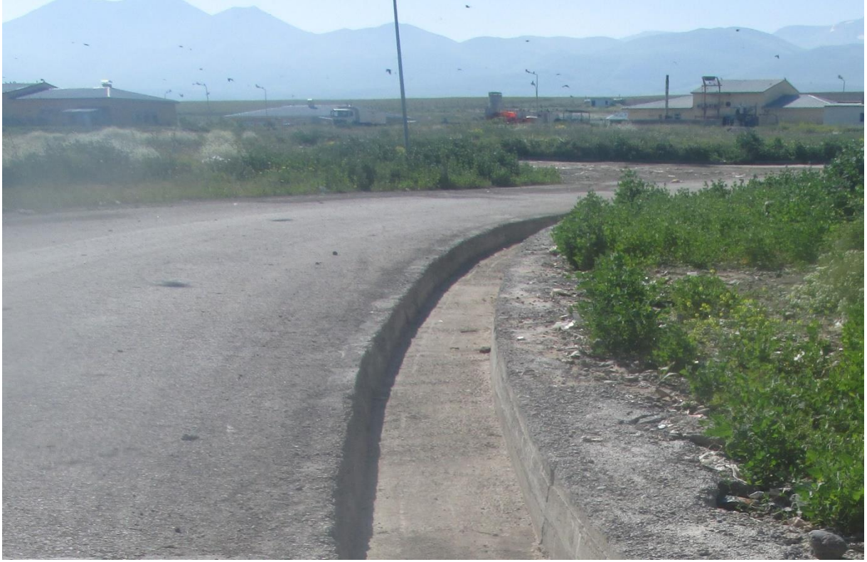
Şekil 42. EKADDT ’de yağmur suyu kanalı
