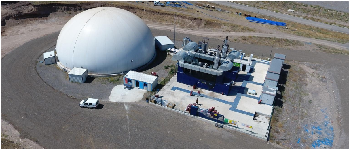
Şekil 28. Metan gazından elektrik üretim tesisi
